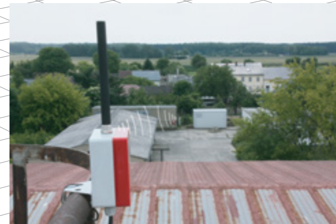
Mit REFUconnect konnten in Plötzin die Wechselrichter mit der 160m entfernten Trafostation verbunden werden.
