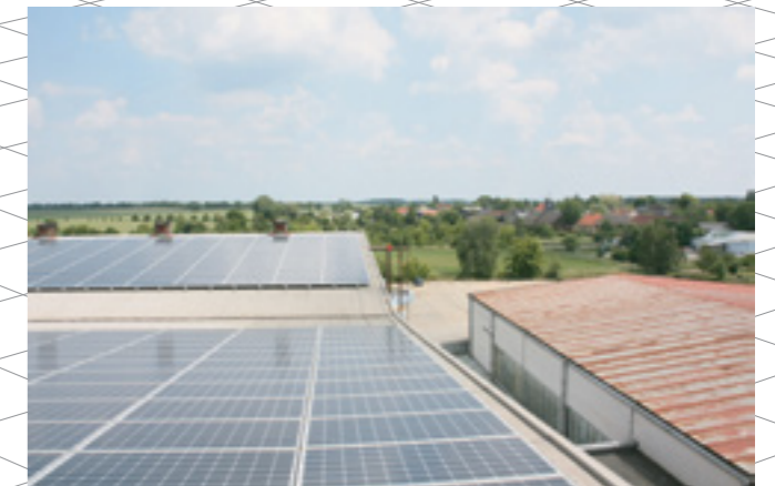
Die PV-Anlage auf dem 2.800 Quadratmeter großen Dach eines Kühlgebäudes hat einen Leistungsumfang von rund 300 Kilowattpeak.
